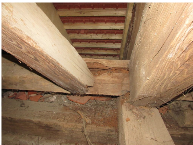
Oštećenja krova crkve
