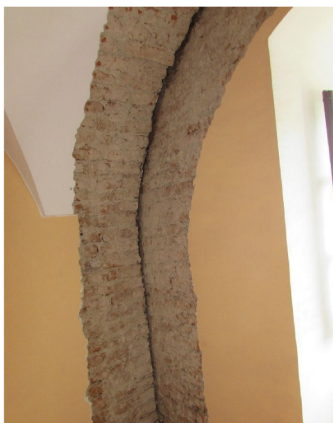
Pukotina na spoju južnog zida i svoda, Pripreme za sanaciju
