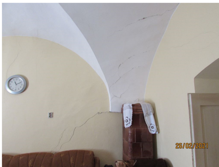
Pukotine na zidu i svodu južnog krila
